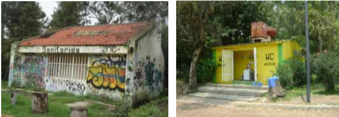
Figura 16. Fotografía del estado actual de los núcleos sanitarios, zonas E y H.
