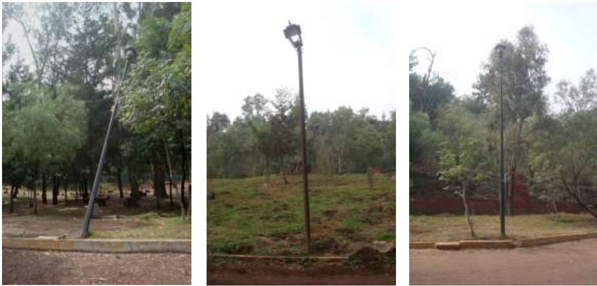
Figura 13. Fotografías del estado actual de las luminarias del AVABN.
